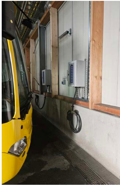
Ivo Bärtschi plant Ladeinfrastruktur für Elektrofahrzeuge – hier eine Anlage in einer Tiefgarage.
