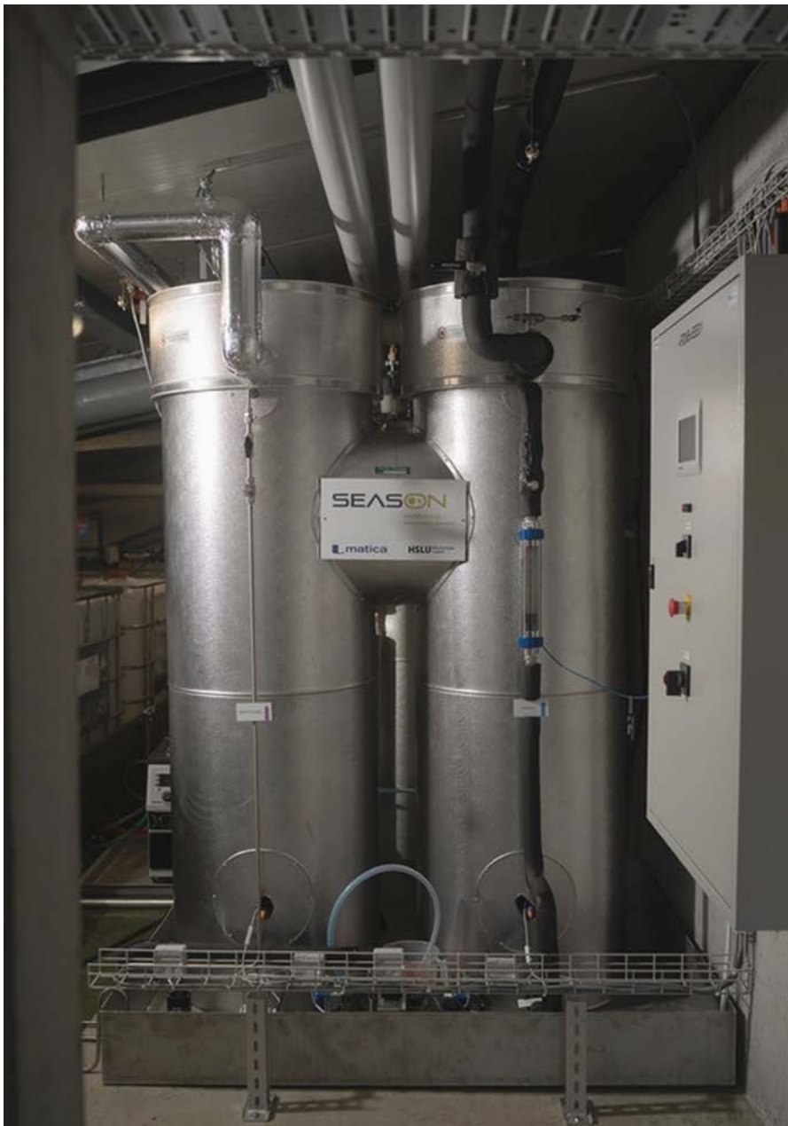
Natronlaugenspeicher sind eine wichtige Innovation in der Gebäudetechnik und ermöglichen es, Sommerwärme verlustfrei über Monate einzulagern und im Winter zum Heizen zu nutzen.
